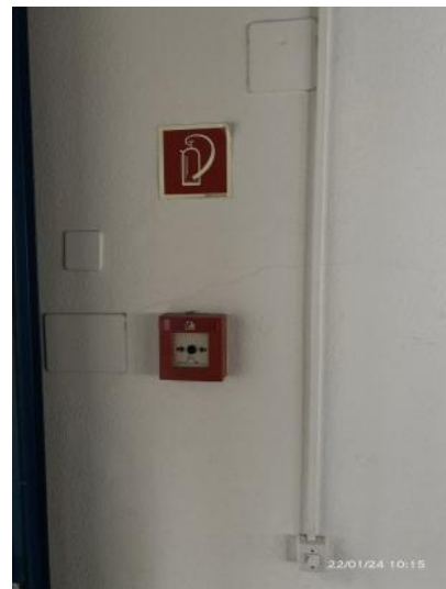
Fire alarm system.JPG
